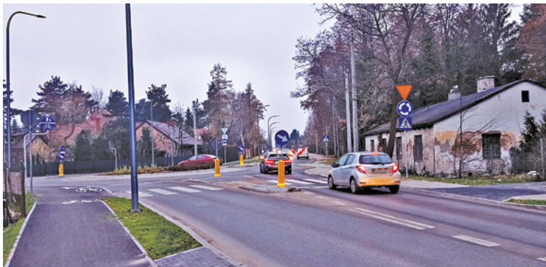
Skrzyżowanie ul. Dworskiej z ul. Pod Bateriami po przebudowie, zdjęcie z 23 listopada 2022 r. Widoczne rondo
