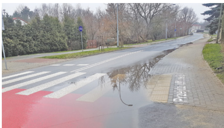
Do zalewania tego miejsca dochodzi przy wyremontowanym przed półtora roku skrzyżowaniu
