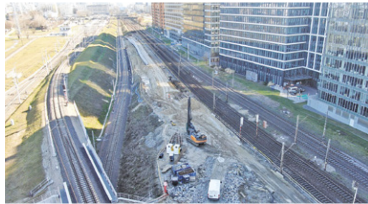
Projekt „Prace na linii średnicowej w Warszawie na odcinku Warszawa Wschodnia – Warszawa Zachodnia” wart jest ok. 2 mld zł netto
