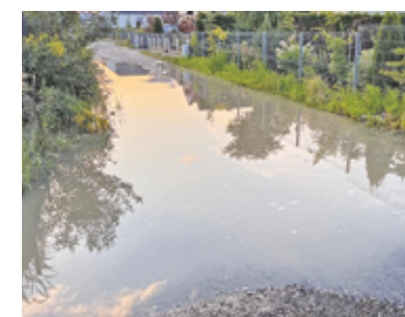
Katuzka na całej szerokości drogi wewnętrznej, na którą splaya woda opadowa z ul. Gogolińskiej
