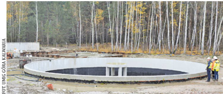
Po zakończeniu inwestycji zakład będzie mógł przyjąć dwa razy więcej ścieków niż teraz
