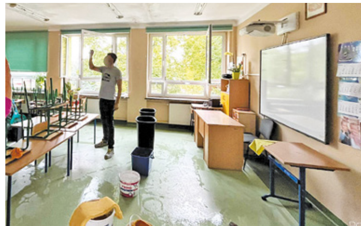
Szkody, jakie wyrządziła woda opadowa, usunie wykonawca remontu dachu
