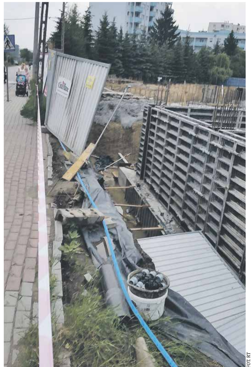
Burza przewróciła ogrodzenie placu budowy
