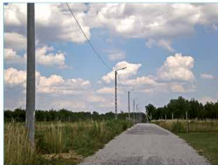
Oświetlenie uliczne - Sobików Parcela
