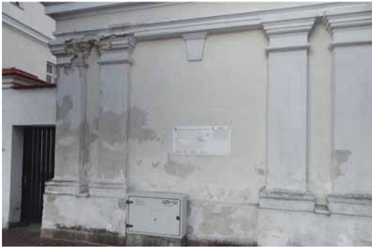
Niszczący mur kościoła parafialnego
