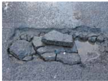
Najnowsza myśl techniczna – zabezpieczenie dziury w ul. Sikorskiego
