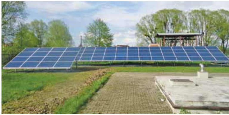
Instalacja przy przepompowni
