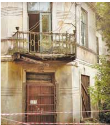
Dawny pensjonat przy ulicy Granicznej. Na budynku widnieje napis: „UWAGA. GROZI ZAWALENIEM”
