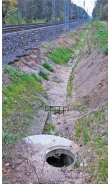
Stan rowu odwodnieniowego daleki jest od ideału.
