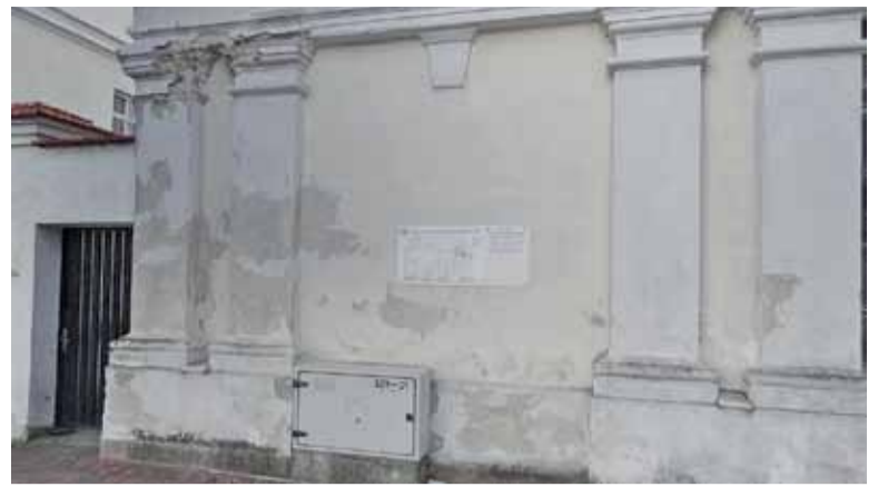
Tak wyglądały mury kościoła przed rozpoczęciem remontu
