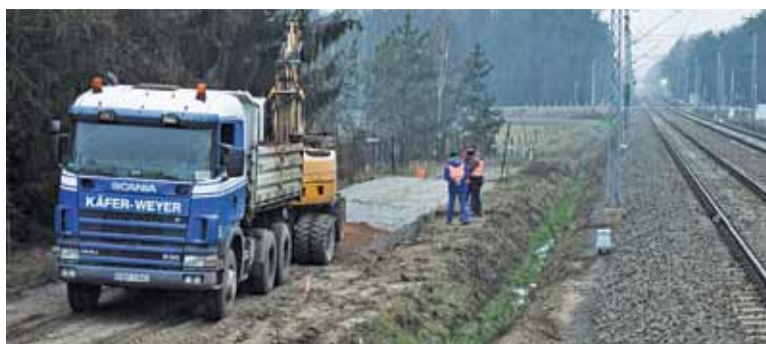
PKP PLK przebudowuje kawałek drogi, który zniszczyła w trakcie modernizacji torów
