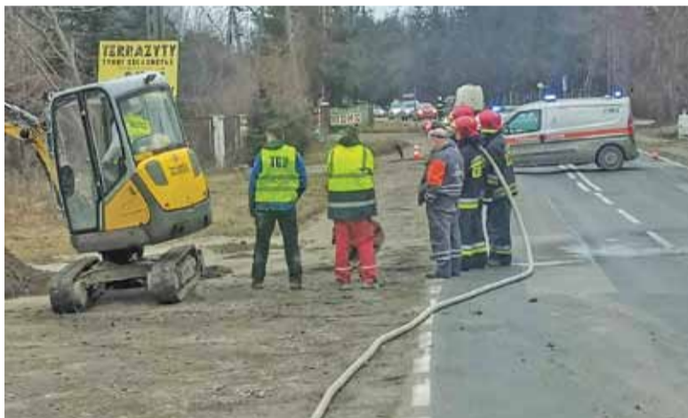
W związku z wyciekami na pewien czas zamknięto drogę
