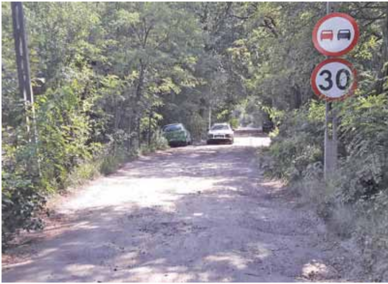
Przejazd gruntowym odcinkiem ul. Millenium wymaga dużej ostrożności i nie służy zawieszaniu samochodów
