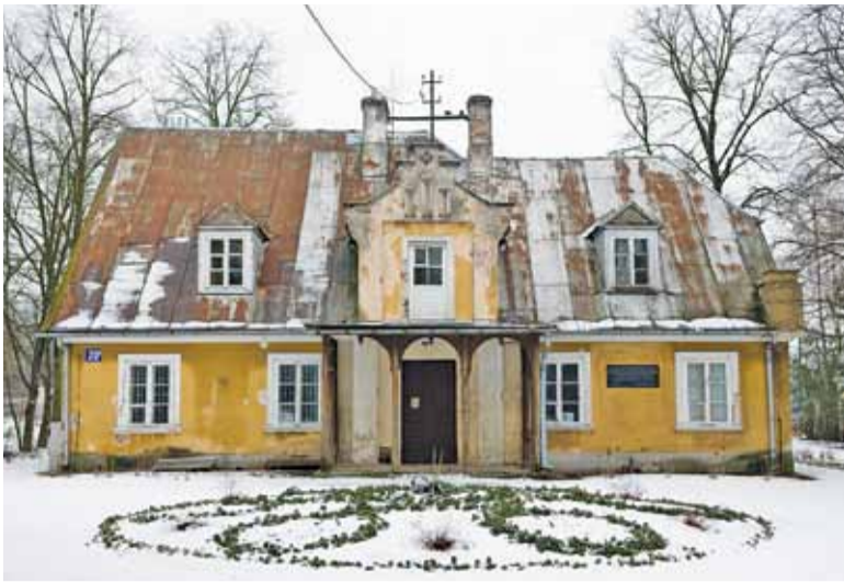
Zabytkowy budynek zdecydowanie nie powinien dłużej czekać na renowację
