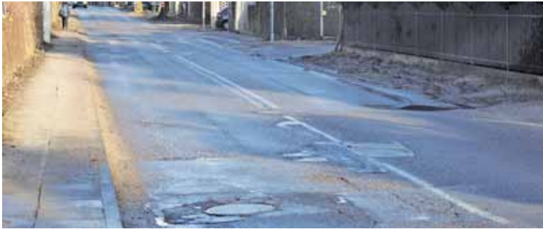
Nawierzchnia Głównej to prawdziwy dramat
