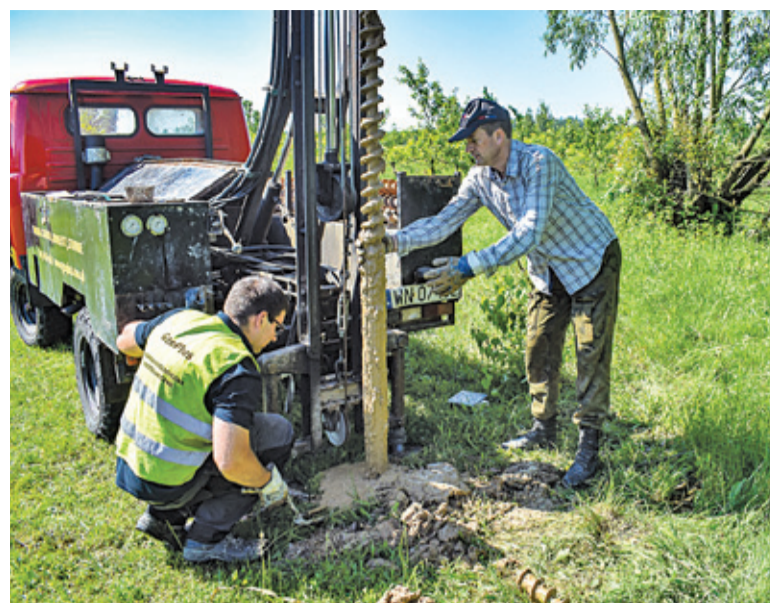
W zeszłym tygodniu na Farmie odbyły się badania geotechniczne, które są początkiem budowy
