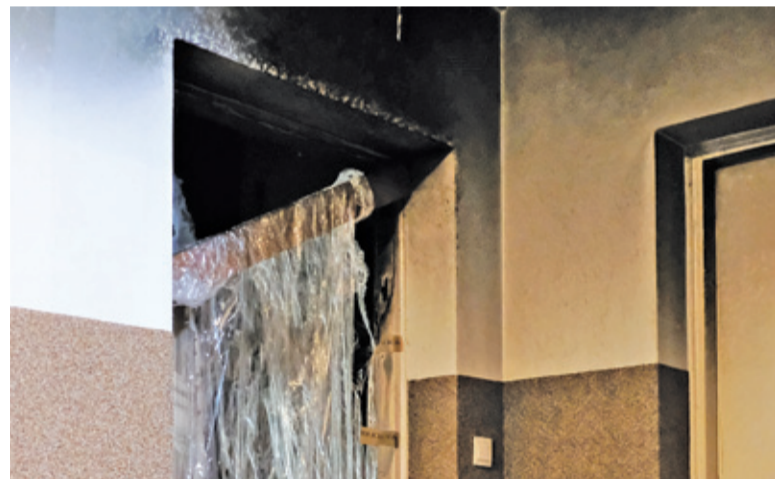
Ogień zniszczył drzwi i znajdujące się nad nimi bezpieczniki
