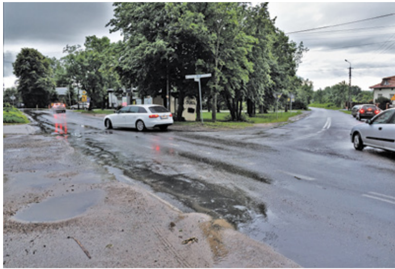
Nawierzchnia szosy jest w złym stanie, a po opadach na łuku stoi woda
