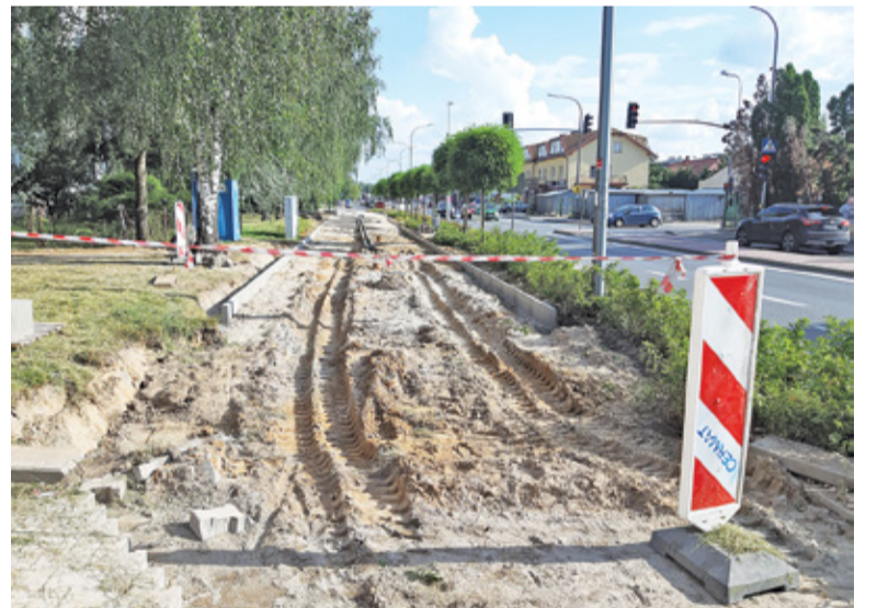
Utrudnienia dla mieszkańców dotyczą głównie wyłączenia na czas budowy części miejsc parkingowych i chodnika po jednej stronie drogi
