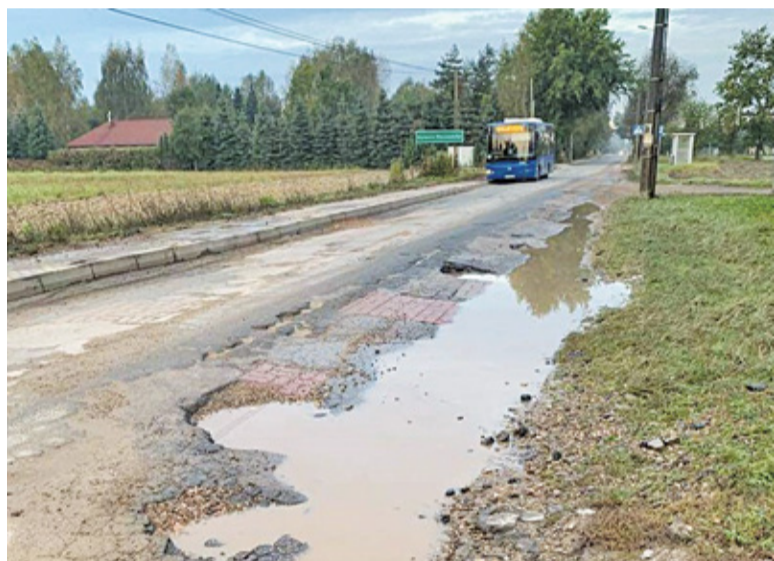
Ukryte pod kałużami dziury to dodatkowe zagrożenie na drodze
