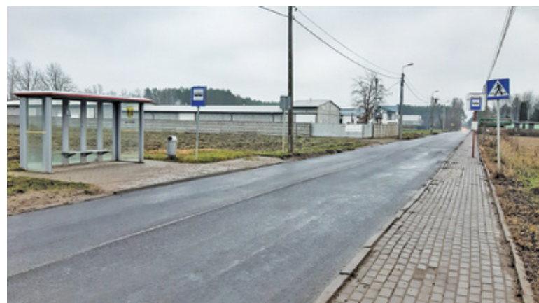
Zniknęły m.in. wielkie dziury przy przystanku autobusowym
