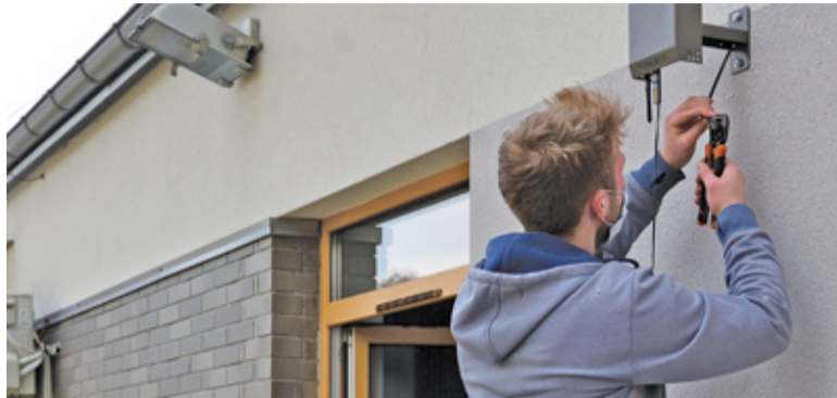
Czujniki zawisły na budynkach gminnych w kilku miejscowościach
