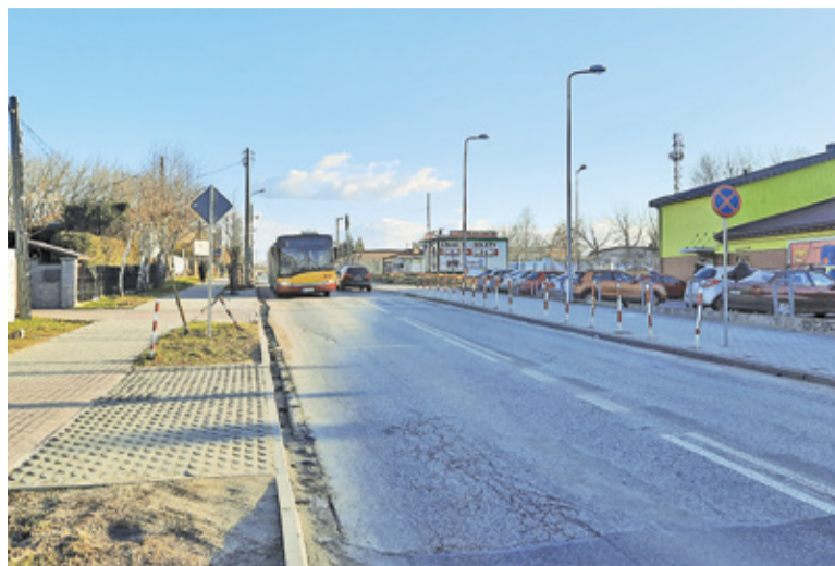
Gmina chciałaby prace na odcinku od ul. Nadarzyńskiej do al. Lotników zrealizować głównie w wakacje
