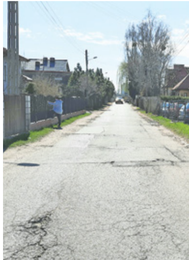
Nawierzchnia jezdni i pobocza pozostawia sporo do życzenia
