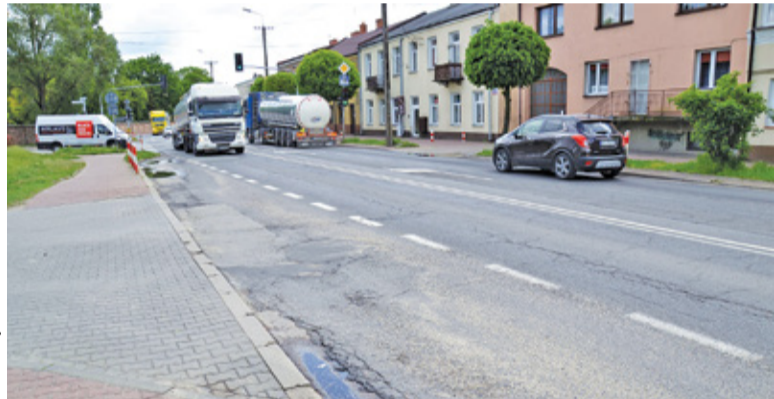
Jakość nawierzchni na głównych drogach od dawna pozostawia wiele do życzenia
