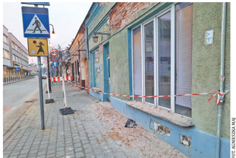
Groźące zawaleniem budynki doraźnie zabezpieczono metalowym ogrodzeniem i taśmą ostrzegawczą
