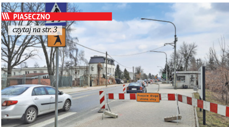
W pierwszym etapie prace będą prowadzone głównie w pasie chodnika. Przesunięty zostanie przystanek autobusowy
