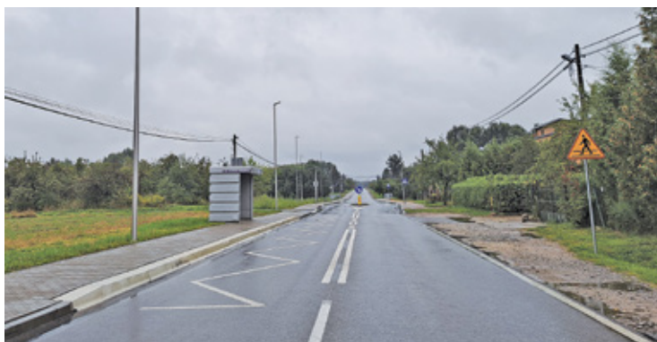
Pierwszy kilometr chodnika oraz przejście dla pieszych z wyspą są już gotowe
