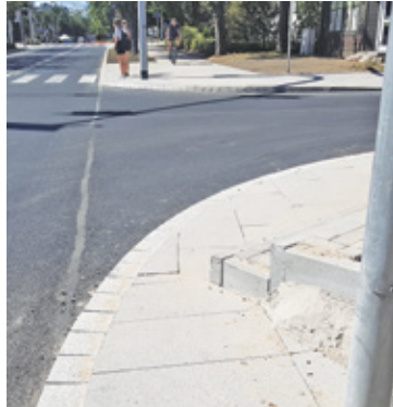
Schody wchodzące w chodnik na rogu ul. Chyliczkowskiej i Warszawskiej zlikwidowano, ale z przejścia i tak nie można korzystać
