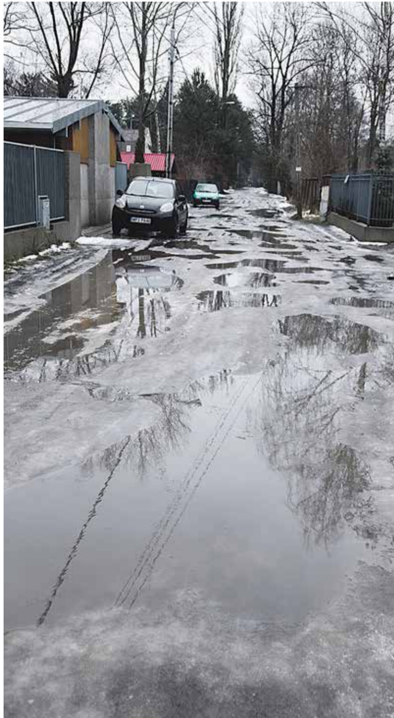
Mimo utwardzenia nawierzchni w trakcie roztopów ulica Kordeckiego tonie w wodzie
